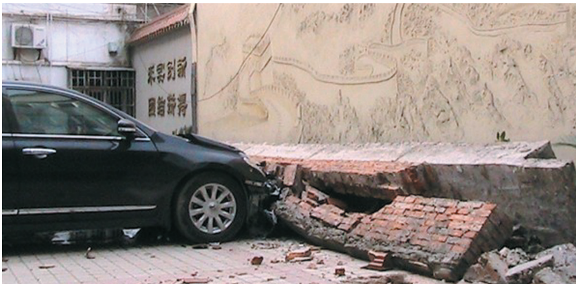
4月10日凌晨,太和县地税局大院内,正迎门的一面围墙遮雨顶檐坍塌,将停在附近的两辆轿车砸毁,其中一辆是警车。所幸事发于夜间,无人员伤亡。据悉,围墙坍塌疑因围墙质量问题所致。 汝亚峰 巩彬 记者 杨文艺 宁大龙 文/图
