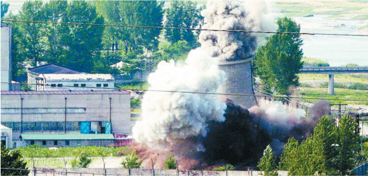
宁边核设施 20 多米高的冷却塔在烟尘中倒塌
